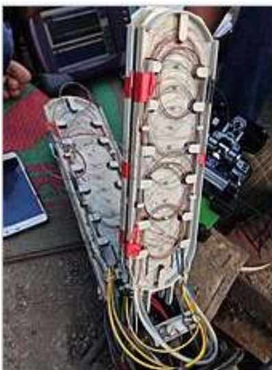
Optički kabl u razvodnoj kutiji za kablove
